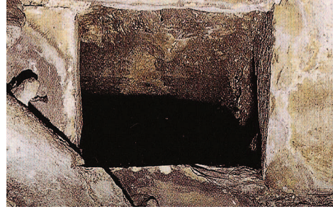
FIGURA III. 32: Corte em área pré-existente, para inserção de novo elemento. Fonte: AIRES-BARROS, 2001b.
